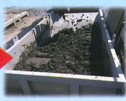
混練後の汚泥はバサつき、水分が分離
