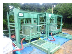
「処理装置」「加圧型脱水機」で汚物分離
