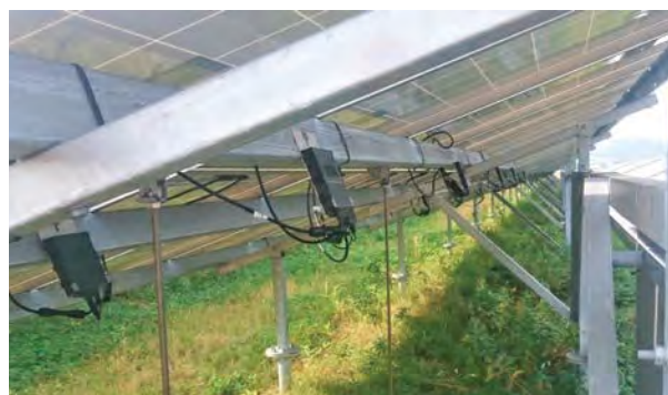
設置パネル（裏側）
