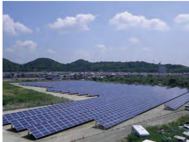
大塩第一太陽光発電所
