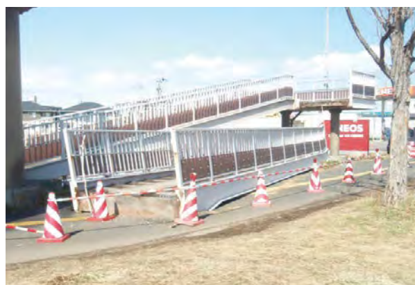
東日本大震災 歩道橋落橋
